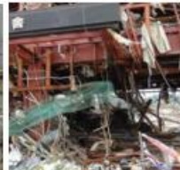
南三陸町防災対策庁舎
